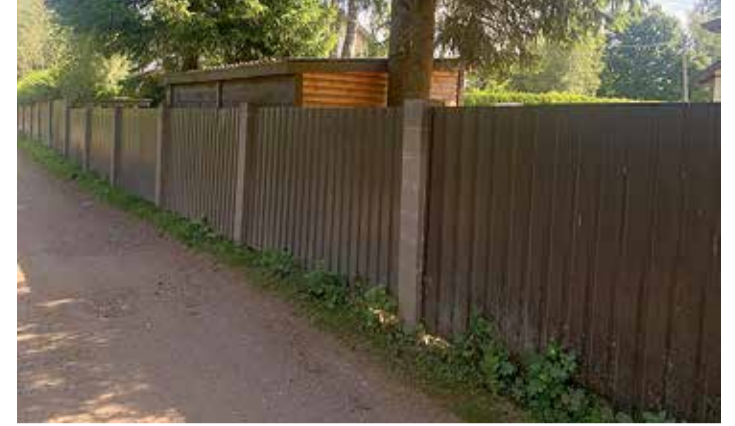
Valesti ehitatud aed. Aed on liiga kõrge ja läbipaistmatu, mistõttu on vastuolus teemaplaneeringuga.
